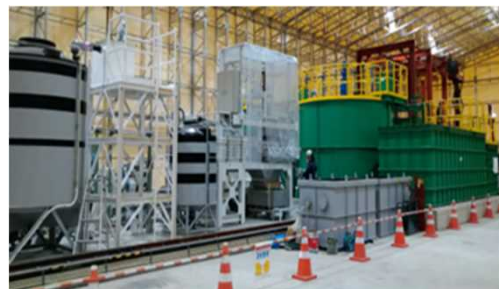
洗浄工程設備
