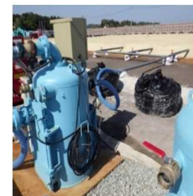
浸透水の集水設備の概観
