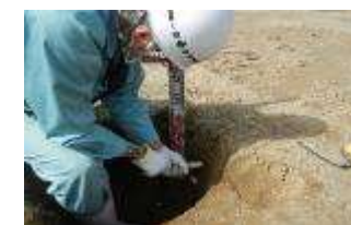
山中式硬度計による硬度確認
