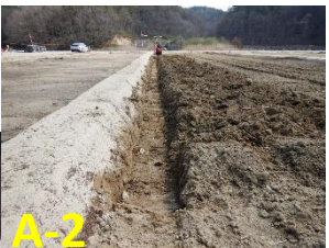
額縁明渠(区画周辺排水溝) (4月12日)
