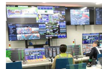
集中監視室の様子
